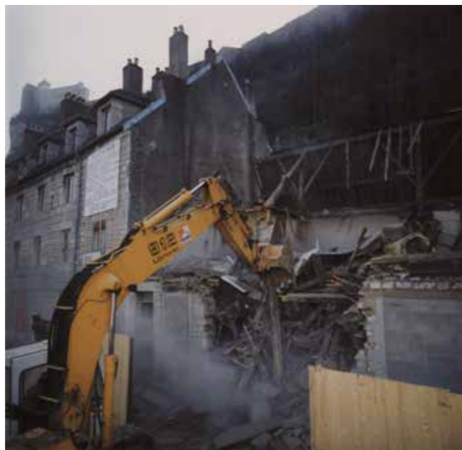
Démolition de maisons du faubourg Rivotte situées sur le tracé du tunnel sous la citadelle, 1993 (AMB, 6Fi176-05).
